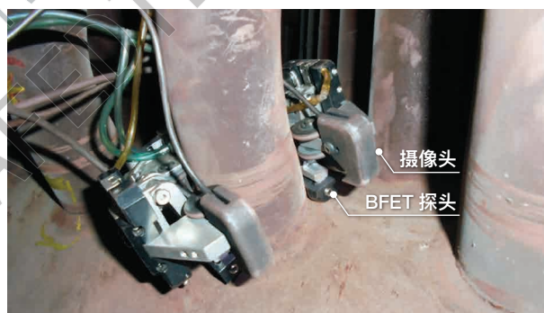
HRSG (热回收蒸汽发生器)
