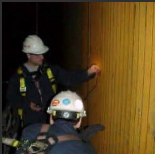
▲ 锅炉内的水冷壁管现场
