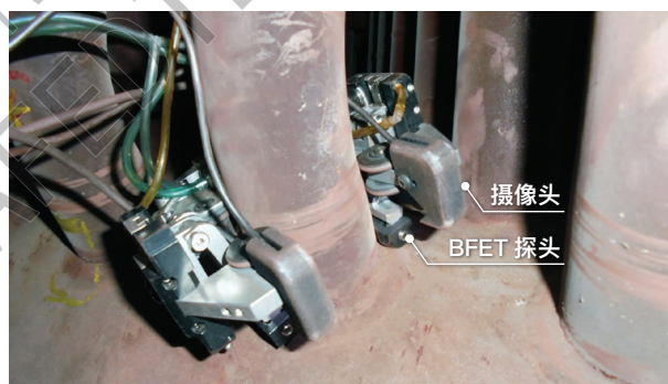
HRSG (热回收蒸汽发生器)
