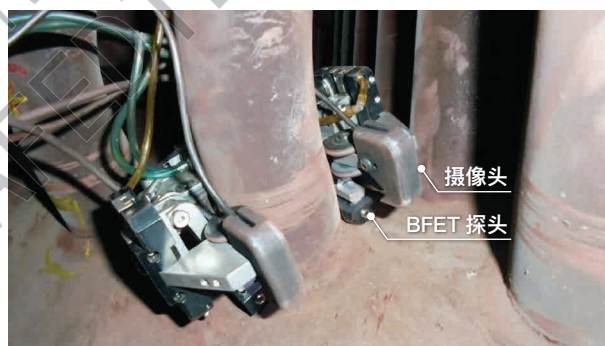
HRSG (热回收蒸汽发生器)
